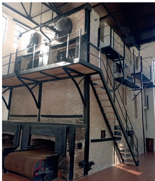
▲ Sala de calderas. Utrillas.
